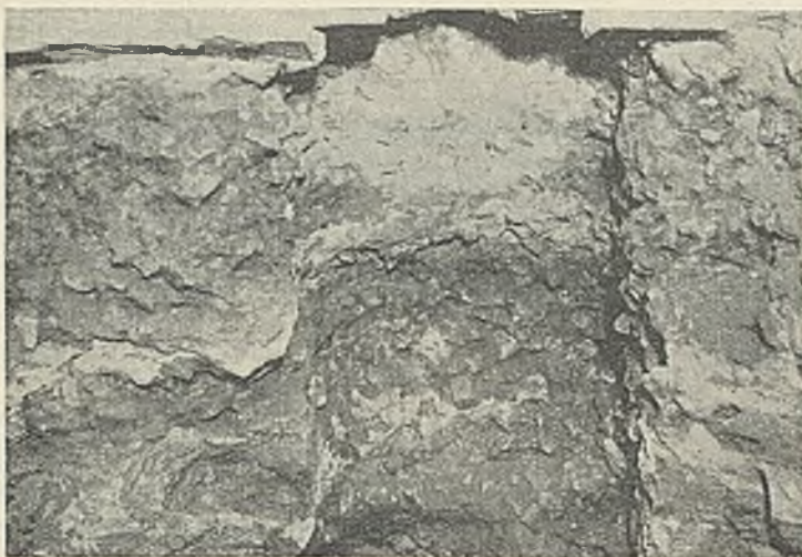
Abb. 9. Beobachtungsschacht A. Der Riß ist nur in der oberen Lage des Sohlenbetons zu erkennen.
