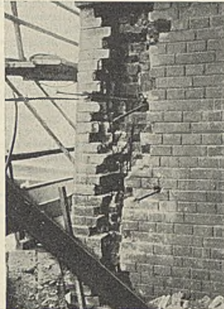
Abb. 8. Ostseite des nördlichen Widerlagers vor der Instandsetzung.
