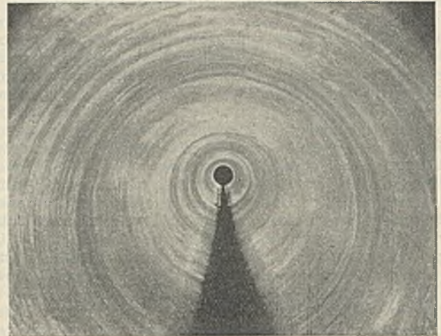
Abb. 44. Innenansicht der nach dem Hume-Verfahren in Einzellängen von 2,44 m geschleuderten, 1067 mm weiten Wasserleitung von Riverside (Kalif). Der dunkle Streifen auf der Sohle ist durch ein photographisches Versehen entstanden.
