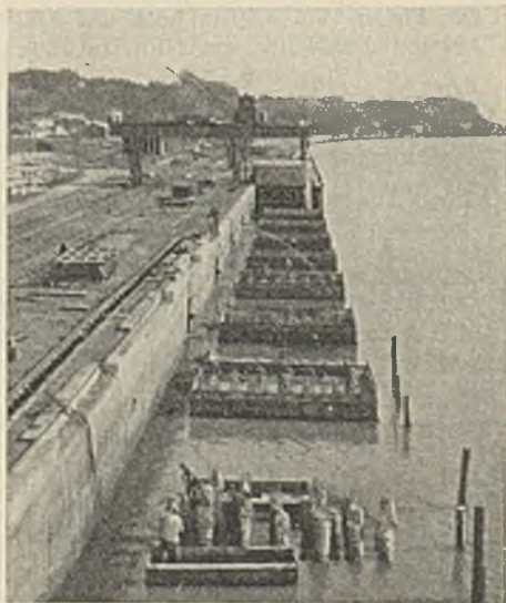
Abb. 8. Der untere Abschnitt der Schalung ist verlegt. Vorn werden die Eisen an den Pfahlsitzen freigelegt zur Erzielung einer Verankerung im Betonkörper des Pfeilers.
