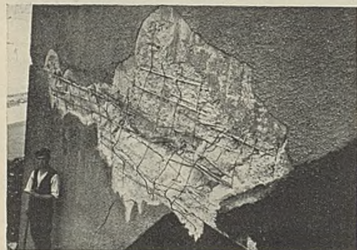
Abb. 14. Unterführung des Beuthener Wassers. Gleitwitzer Erdfang. Einzelheiten des schweren Schadens in der nördlichen Längswand. (Sommer 1924.)
