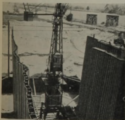
Abb. 8. Schleuse Hünxe. Faltungen in einer gerammten Wand vor Anbringen der Ankergerüstungen und dem Ausrichten.
