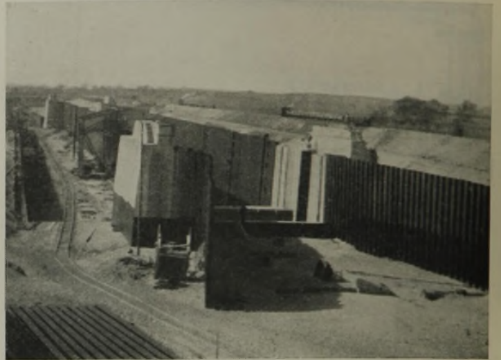
Abb. 16a. Schleuse Hünxe fertig betoniert und gerammt, vom Oberhaupt aus gesehen. Im Vordergrund die Leitwerkswände aus Larsseneisen (noch nicht verankert und ausgerichtet).
