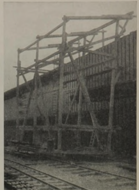
Abb. 12. Schleuse Hünxe. Montagegerüst für das Anbringen der Gurtungen der Kammerwände. Hochziehen der oberen Gurtung.
