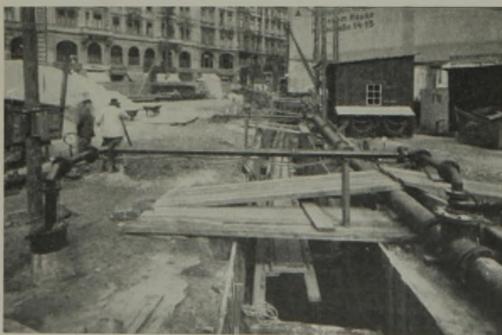
Abb. 10. Parallelmauer am Umformerwerk Alexanderplatz zu Berlin. Blick in die Baugrube, im Hintergrund rechts neben der Abflußleitung die Schaltstelle.
