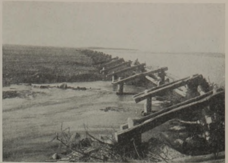
Abb. 3. Wolfsche Wand an der Tessinmündung nach Ablauf des ersten Hochwassers.
