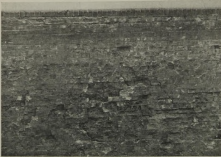
Abb. 4. Verblendklinker-Zerstörung an der Schleuse Lehnitz.
