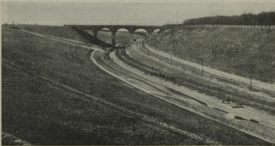
Abb. 7. Nach Beendigung der Bauarbeiten derselbe Blick wie Abb. 5. In der Mitte links der Streckengleise die Planumverbreiterung mit den befestigten Gräben an beiden Seiten. Rechts das höher als die Streckengleise liegende Umfahrgleis und Befestigungen des Böschungsfußes. Um die Brücke der Sandkegel, hinter ihr die westlichen Abflachungen.
