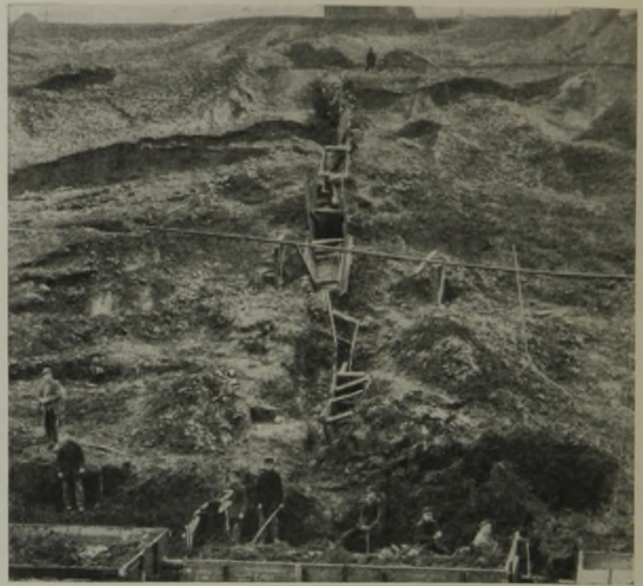
Abb. 1. Bewegungen in den Tonen während der Bauarbeiten. In der Mitte ein verdrückter Entwässerungsgraben. Rechts und links oben Abrißflächen.
