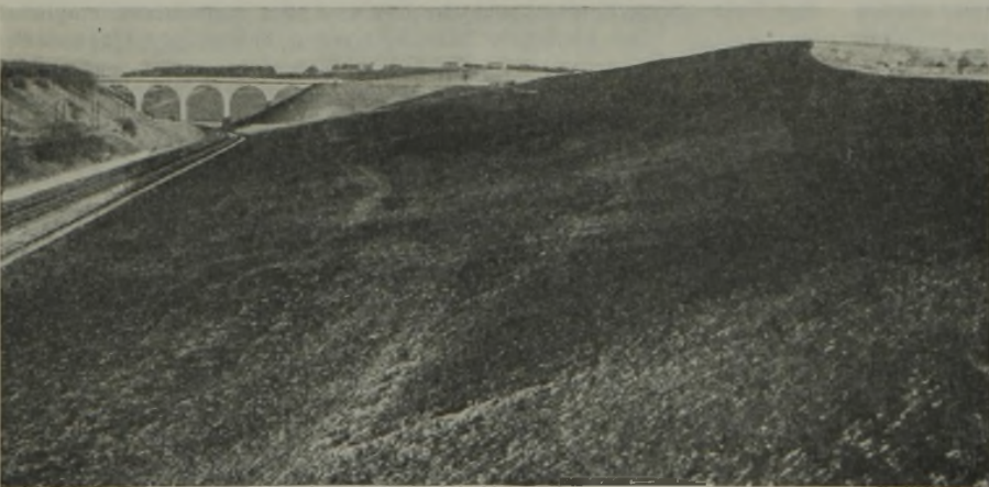
Abb. 8. Fertigstellung der Bauarbeiten, Blick von Westen. Rechts oben die steiler gehaltene, in Sand anstehende Böschung. Um die Brücke der Sandkegel mit der Futtermauer an seinem Fuß. Hinter der Brücke der östliche Teil der Abflachungen. Links eine kleine Futtermauer als Böschungsfußbefestigung.
