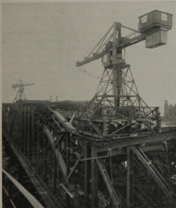
Abb. 20. Vorbaukrane in der Stellung zwischen zwei Überbauten. In dieser Stellung wurden sie von den zuerst hergestellten Überbauten für den Personenzugverkehr auf die Überbauten für den Güterzugverkehr verschoben.
