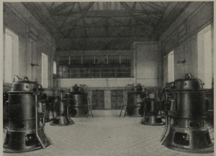
Abb. 10. Motorenraum. Im Hintergrunde oben die Hochspannungsanlage, links unten an der Wand die Niederspannungsanlage.
