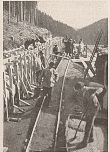
Abb. 18. Seitenansicht des eingeschalteten Rohres.
