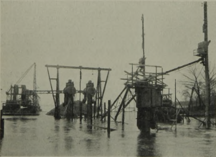
Abb. 19. Überflutete Baustelle des linken Pylonenpfeilers bei außergewöhnlichem Hochwasser.
