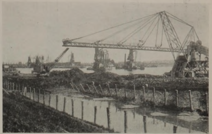
Abb. 29. Burchardkai — Westteil. Einbringen der Belastungsschicht. — Beginnende Bewegung des Dammes an den verdrückten Gerüstpfählen zu erkennen.
