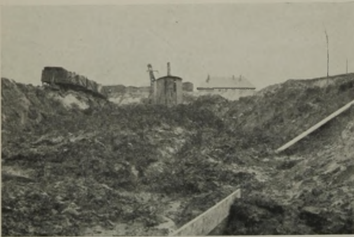
Abb. 7. Aufquellendes Moor in der Baugrube. — Rechts Rutschung.
