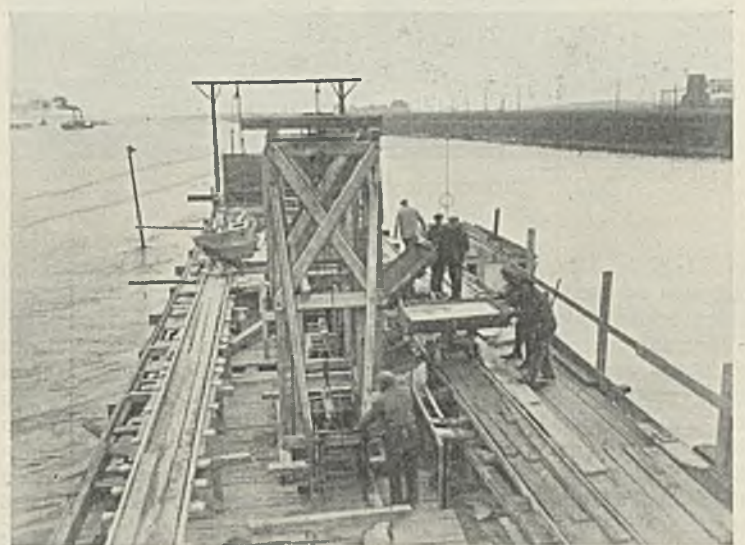
Abb. 8. Trichtergerüst, Bauwinde, Betonrundkipper. Im Hintergrunde mit Nut versehene Schalttafel im Portalkran hängend.
