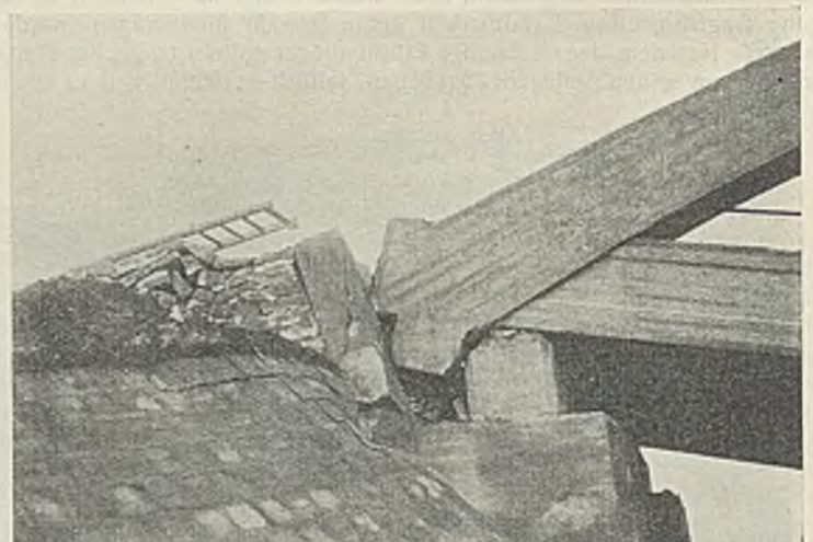
Abb. 12. Das Auflager des wiesenseitigen Bogens hat sich um rd. 1,0 m nach dem Lande zu verschoben.
