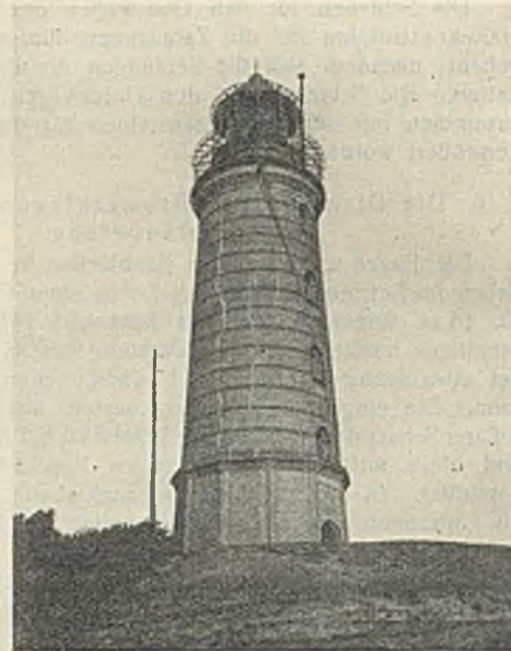
Abb. 4. Risse in der Verblendung.
