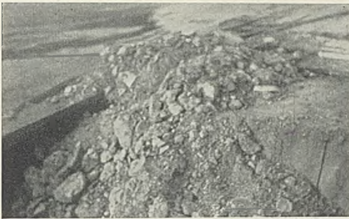
Abb. 22. Bröckelige Betonmasse aus dem stadtseitigen Strompfeiler, rd. 7,3 m unter Mittelwasser mit dem Sandgreifer gehoben.
