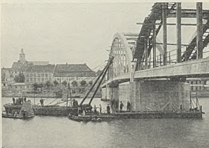
Abb. 2. Der Hebebrahm zieht die eisernen Spundwände an der stromauf gelegenen Seite des wiesenseitigen Strompfeilers.
