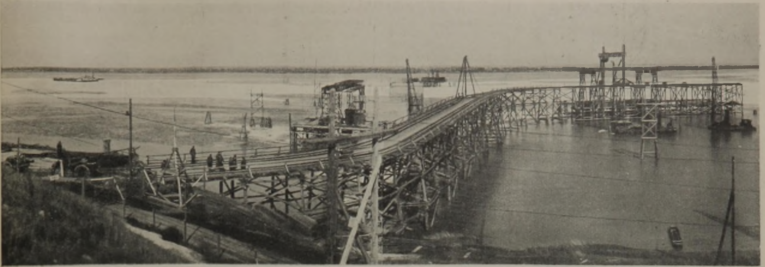
Abb. 2. Senkkasten-Montagegerüst und Entladestation in der Donau mit Transportsteg zum Lagerplatz am Belgrader Ufer. Aufnahme vom 17. März 1929.
