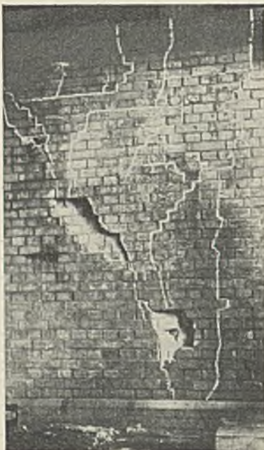
Abb. 4. Ansicht des zerstörten Widerlagers.
