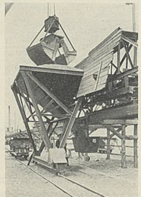
Abb. 4. Fahrbarer Kiesbunker am Kieslager zur Beschickung der Hängebahn.
