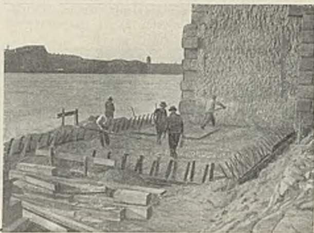
Abb. 10. Arbeitsebene für den Senkkasten des rechten Widerlagers mit bereits verlegter Senkkastenschneide. Rechts im Bilde Abbruchfläche des alten Widerlagers.
