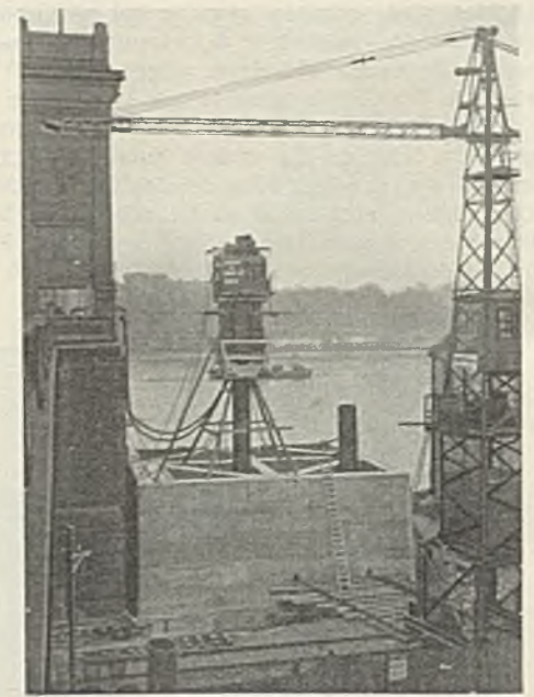
Abb. 18. Senkkasten des linken Widerlagers vor dem Absenken. Die erste Luftschleuse ist eben aufgesetzt, die zweite fehlt noch, der Schacht ist jedoch sichtbar.
