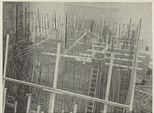
Abb. 15. Blick auf den oberen Teil der Eisenbewehrung des Senkkastens am linken Ufer mit den beiden Schleusenschachtröhren.
