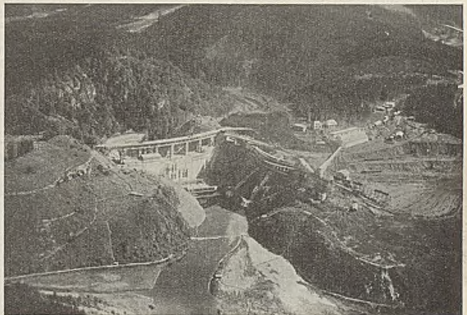
Abb. 12. Saaletalsperre am Bleiloch. Luftbild der Baustelle. Aufnahme der Junkers-Flugzeugwerke Dessau. Luftbild-Zentrale Leipzig.
