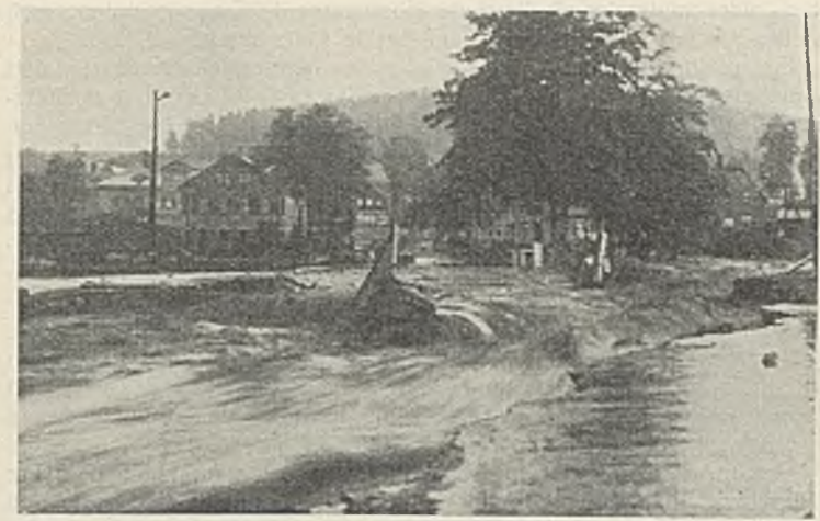
Abb. 7. Zerstörte Staatsstraßenbrücke (Fernstr. 93) unterhalb Wittigsthaler-Hof.
