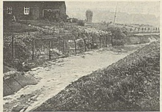
Abb. 5. Böschungszerstörungen an der Berne.
