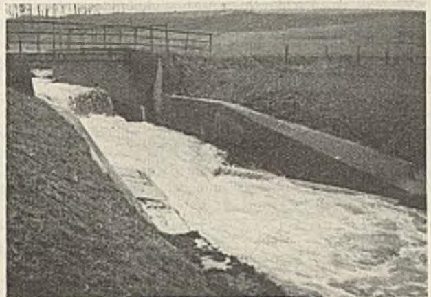
Abb. 17. Absturz in der Emscher bei km 62,9.
