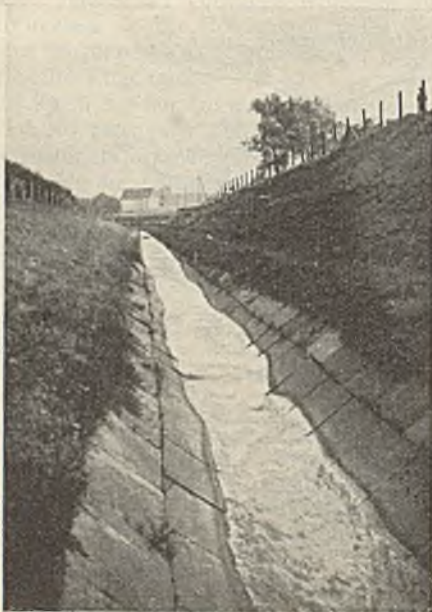
Abb. 4. Plattenverlagerung am Marbach.
