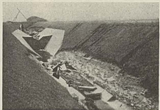
Abb. 20. Zerstörungen unterhalb eines senkrechten Absturzes ohne Energievernichtung.
