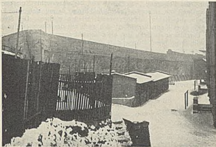
Abb. 6. Futtermauer gegenüber km 78,8. Ansicht.
