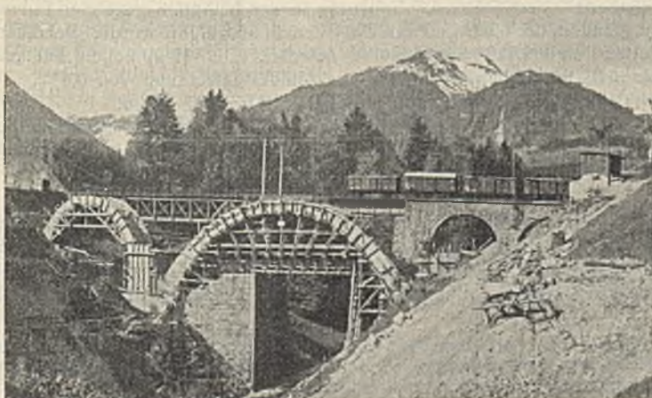
Abb. 9. Lehrgerüst für den Hauptbogen. Bach und Straße werden durch den abgesenkten alten Blechträger überbrückt.
