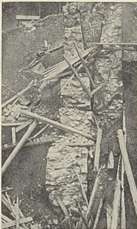
Abb. 6. Beide Flügel sind vorgegerutscht. Der rechte (im Bilde links) ist teilweise in den Schlitz zwischen den Flügeln abgesunken und hat sich an den linken Flügel angelehnt.
