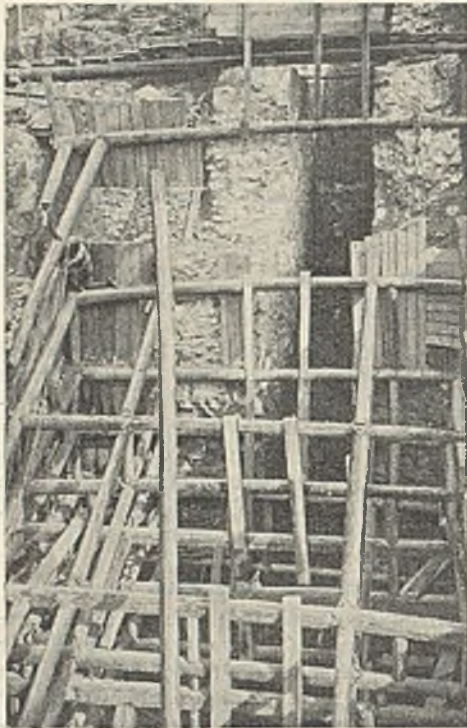
Abb. 4. Bölung der großen Baugrube beim Salzburger Hauptwiderlager. Die Längshölzer haben sich stark nach oben durchgebogen. Einblick in den ausgeräumten Schlitz zwischen den Flügeln.
