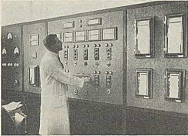
Abb. 21. Befehlsstand für den Betriebsleiter des Klärwerks.
