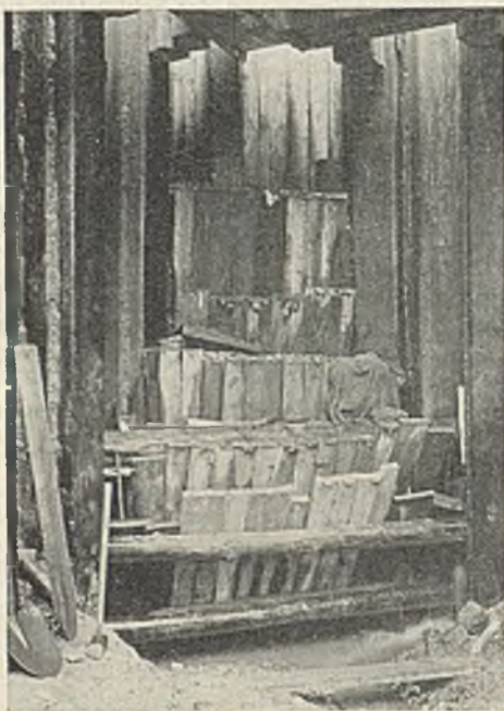
Abb. 17. Die Verpfählung einer Leckstelle in der eisernen Spundwand.
