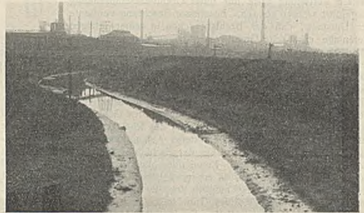
Abb. 3. Abgesunkene und verschlammte Alte Emscher bei km 8.
