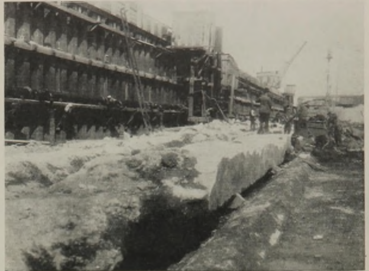
Abb. 6. Spalt zwischen Mauer und Sohle.
