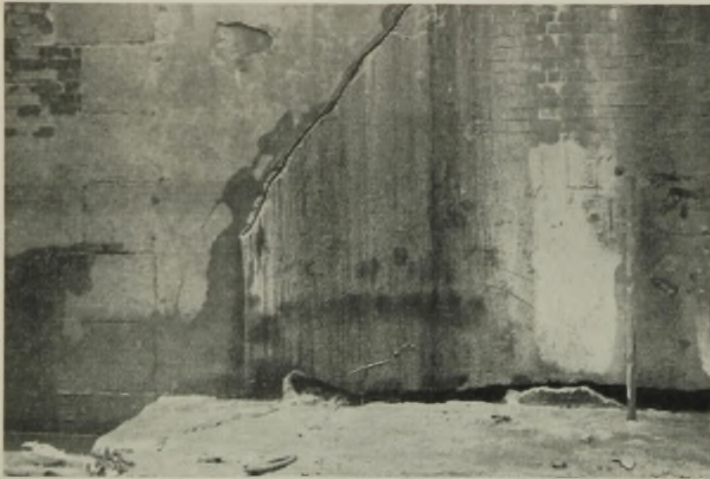
Abb. 9. Ablösung der Sohle von der Mittelmauer zwischen beiden Schleusen.
