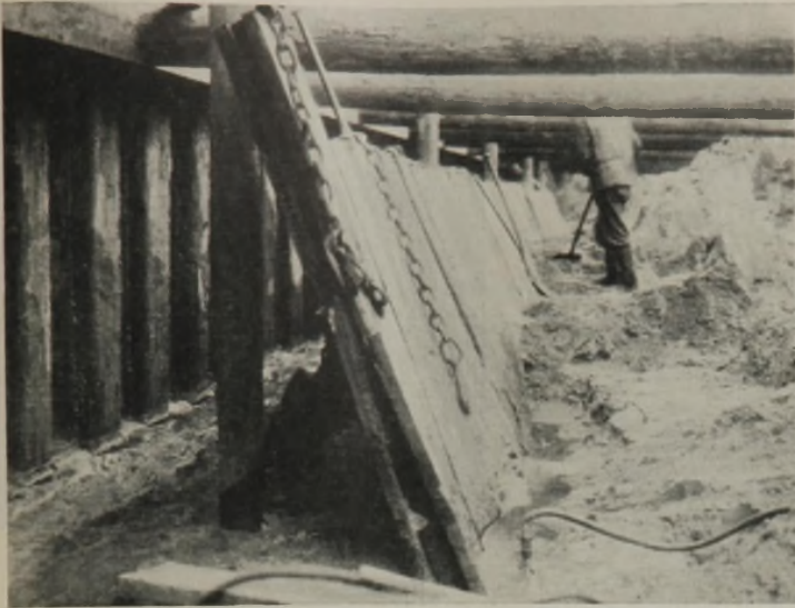
Abb. 5. Beim Verschieben der Schleusenmauer schiefgestellte Spundwand.
