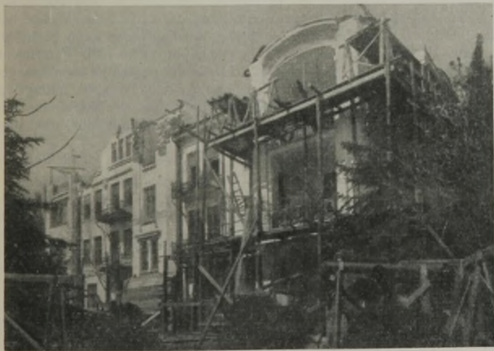
Abb. 10. Das Auseinandernehmen der durch Erdbeben beschädigten Wände des dritten Stockwerkes und die Umgestaltung des Gebäudes in ein zweistöckiges.
