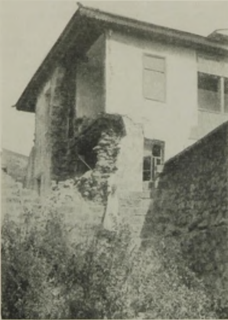
Abb. 2. Der Einsturz der Wand, die zum Meere gegen den seismischen Stoß des Epizentralerdbebens gewendet ist.
