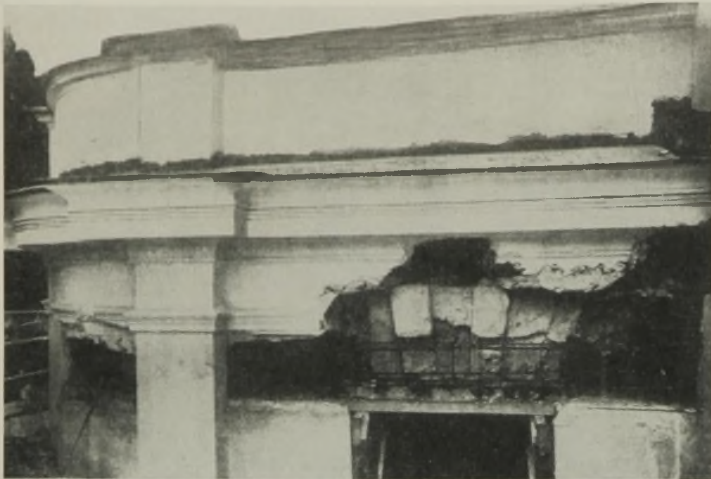
Abb. 12. Schlitze in den Wänden in Höhe der Fensterstürze zur Verstärkung der Wände mit Eisenbetongurten.
