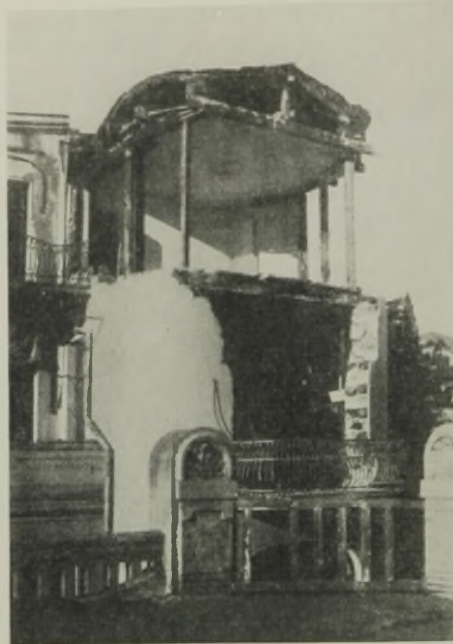
Abb. 4. Die durch Fenster- und Türöffnungen geschwächten und der Zerstörung ausgesetzten Wände.
