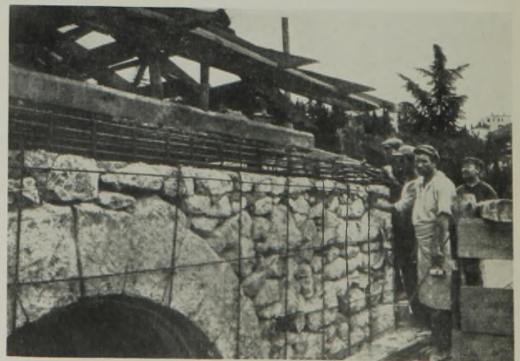
Abb. 16. Bewehrung der Wände durch ein Netz zur Verstärkung ihrer Standfestigkeit mittels Torkret.
