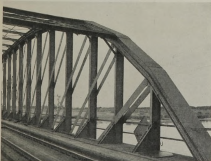
Abb. 26. Elbebrücke bei Dömitz. Unverstärkter Überbau.
