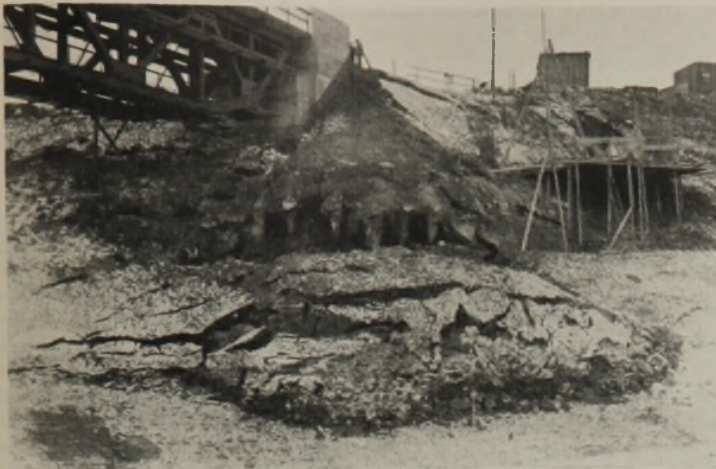
Abb. 30. Mittellandkanal. Nördliche Widerlager der Eisenbahnbrücke Gifhorn—Braunschweig mit rutschendem Böschungskegel.
