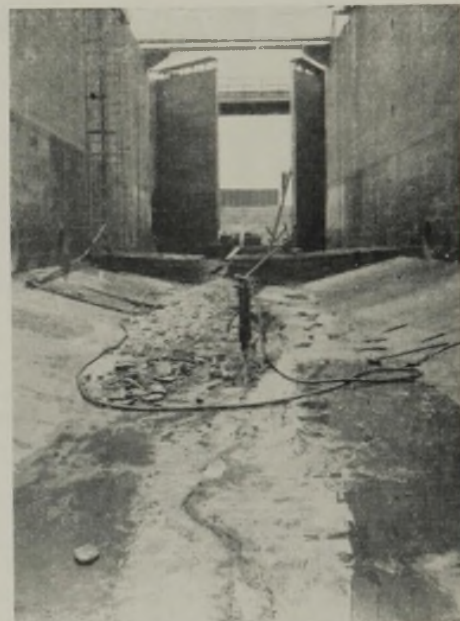
Abb. 40. Schleuse Gleesen. Längsriß in der Schleusenammer.
