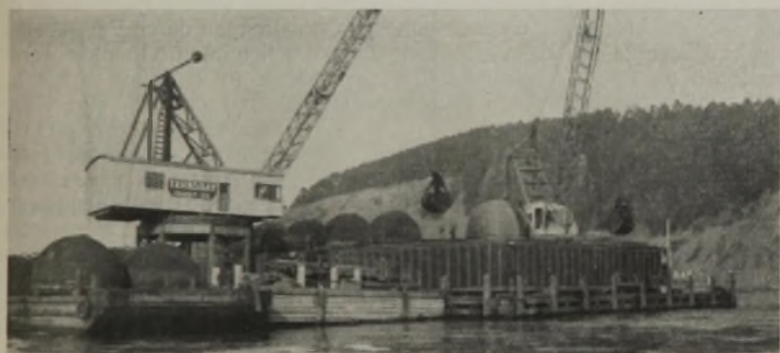
Abb. 4. Senkkasten des am weitesten östlich gelegenen Turmpfeilers der Hängebrücken nach dem Einschwimmen und Absenken bis auf den guten Baugrund.
