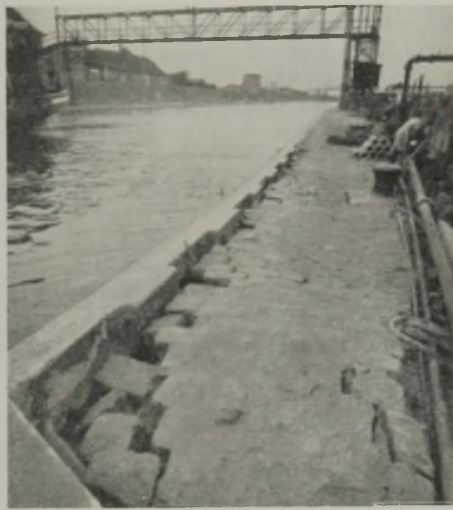
Abb. 11. Sackungserscheinungen auf dem Trennungsdamm.
