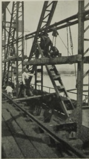
Abb. 14. Ein neuer Knotenpunkt fertig montiert. Im Hintergrunde ein Knotenpunkt vor dem Ein- ziehen des Knotenbleches.
