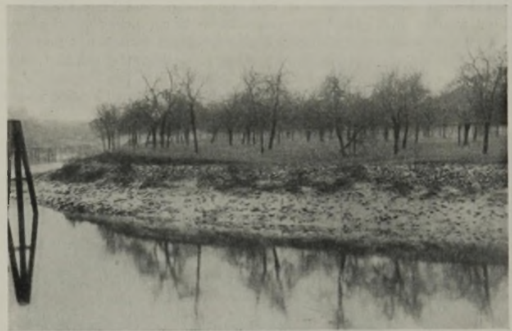
Abb. 2. Jetziger Zustand einer Uferbefestigung von 1930.
