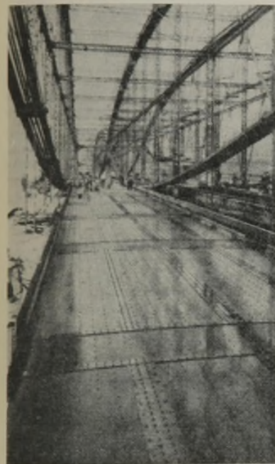
Abb. 4. Fahrbahn für Kraftfahrzeuge. Der fertig montierte Aluminiumplattenbelag vor dem Aufbringen der Kaltasphaltdecke.
