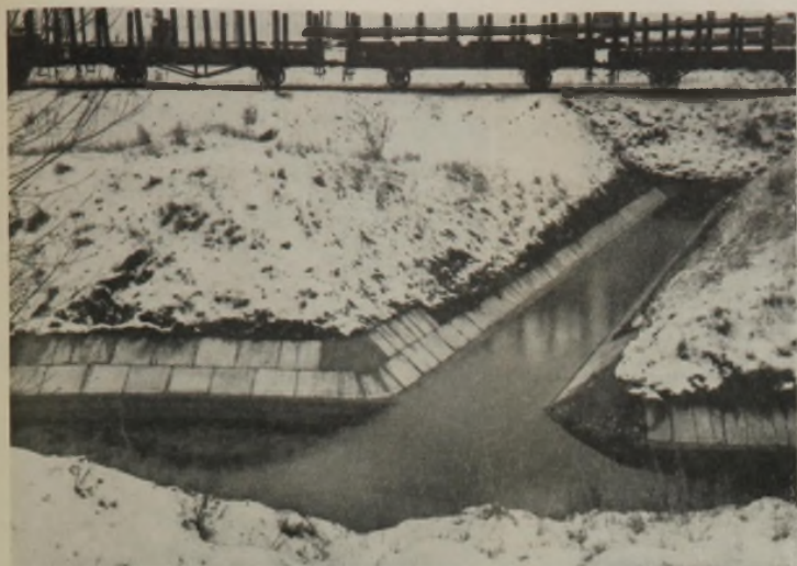
Abb. 4. Einmündung der Ableitungsrohre in den Hüllgraben.
