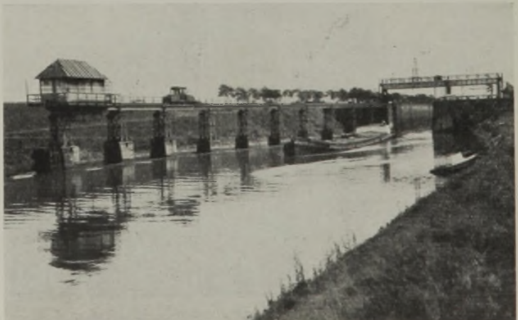
Abb. 7b. Das nicht gesunkene untere Leitwerk der Schleuse V.
