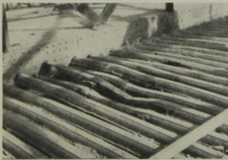
Abb. 24. Durch Rauchangriff und Rost zerstörte Zoresisen.
