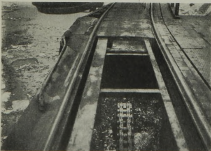
Abb. 10. Im Oberwasser schwimmende Eismassen behindern das Getriebe des Gegengewichtes im Oberhaupt der gesunkenen Schleuse IV.
