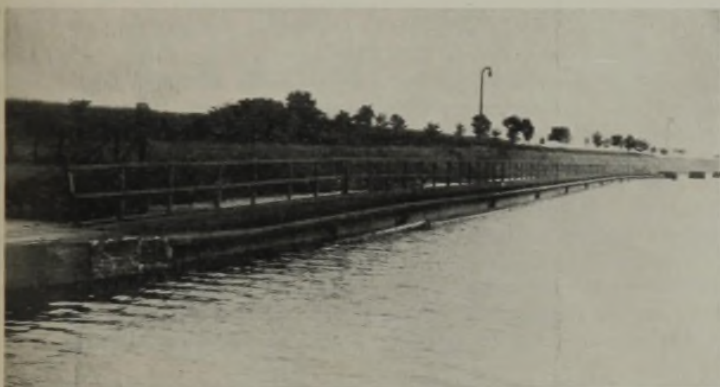
Abb. 6a. Das unter Wasser gesunkene obere Leitwerk der Schleuse IV.
