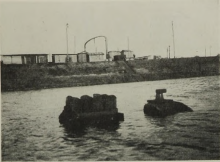
Abb. 8. Abgesunkene Dalben im Unterwasser der Schleuse IV.
