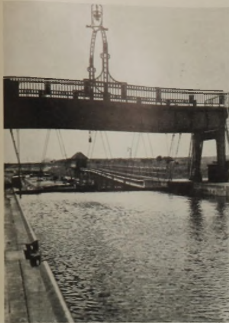
Abb. 5a. Das Untertor der gesunkenen Schleuse IV droht überflutet zu werden.
