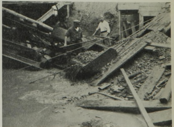
Abb. 21. Das Entfernen des Bodens unter den Widerlagerhälsen beim Absenken des rechten Widerlagers.
