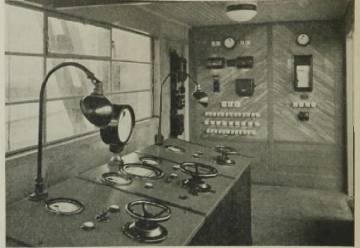
Abb. 27a. Schaltpulte und Schalttafel im Führerhaus.
