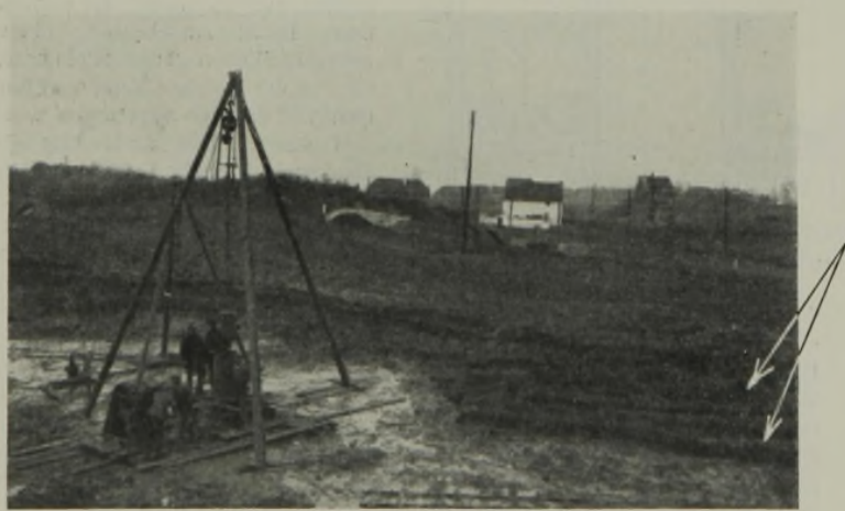
Abb. 4. Schwimmender Boden bei Station 250 m.
