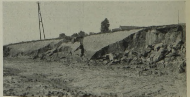
Abb. 5. Zerstörung der Böschung bei Station 950 m.
