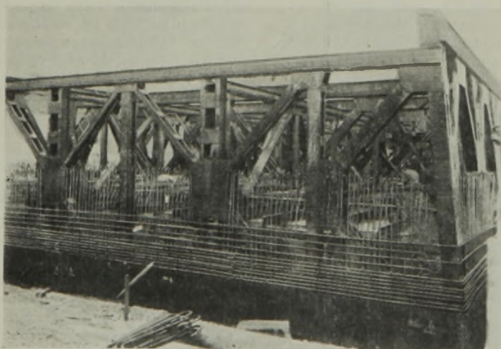
Abb. 13. Stahlgerippe des Ostpfeilers mit zusätzlicher Rundeisenbewehrung der Schneide und Arbeitsraumwände; Arbeitsraum innen eingeschalt.
