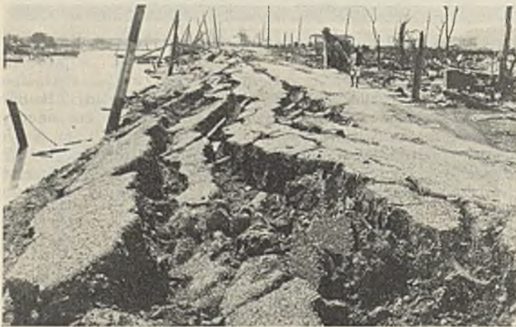
Abb. 3. Bodenrisse am Kanalufer, Yokohama 1923.
