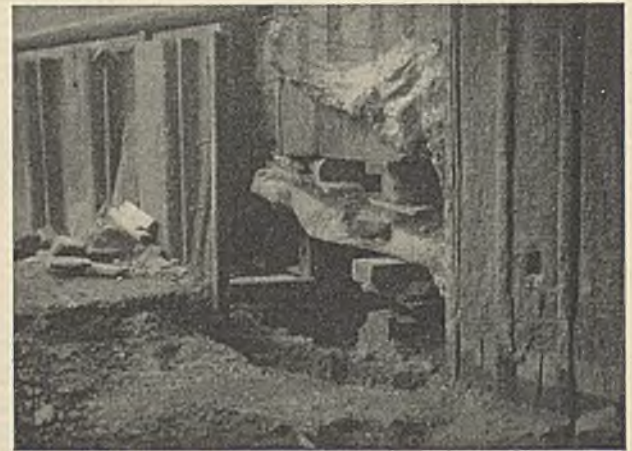
Abb. 20. Die vorgefundene Unterspülung des noch stehenden Pfeilers der „Langen Brücke“ aus dem Jahre 1390 vor der Unterfangung.
