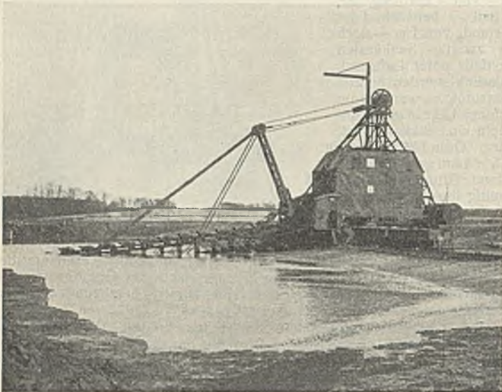
Eimerkettenbagger zur Gewinnung des Sandbodens für den hohen Damm des Mittellandkanals bei Magdeburg.
