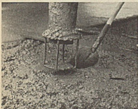
Abb. 20. Auffangteller unter den Schüttrohren.
