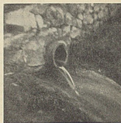
Abb. 11. Auslauf einer TE am Ende des Bahneinschnittes.
