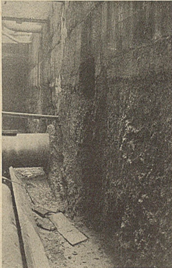
Abb. 5. Lichtschachtwand, durch Säure angegriffen.
