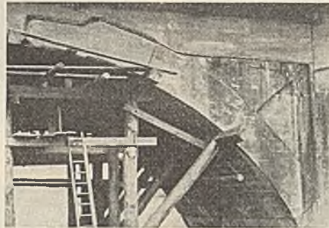
Abb. 9. Bruchfuge freigestemmt vor Ausführung der Torkret-Dichtungleisten.
