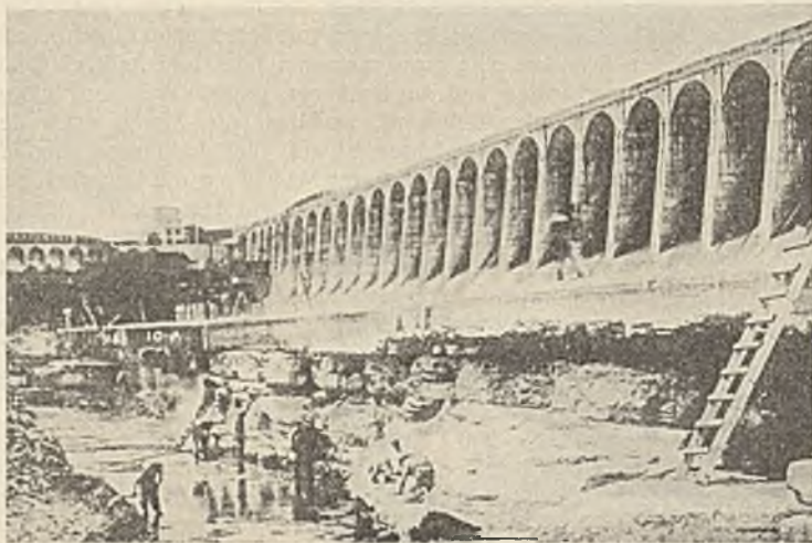
Abb. 1. Zerstörungen infolge von Wirbelbildung am Sturzbett der Wilsonstauanlage.
