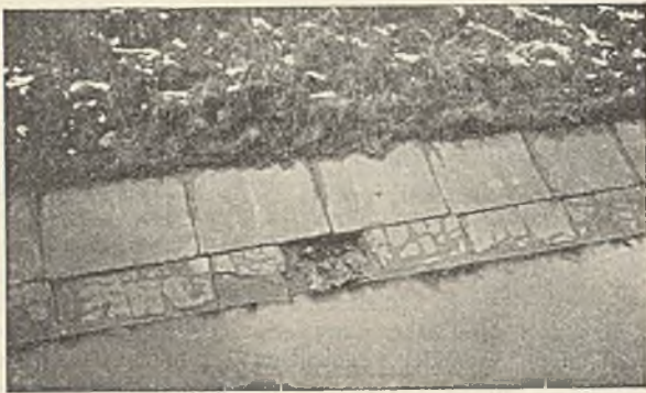
Abb. 11. Zerstörung einer Betonauskleidung durch sulfathaltige Wasser.
